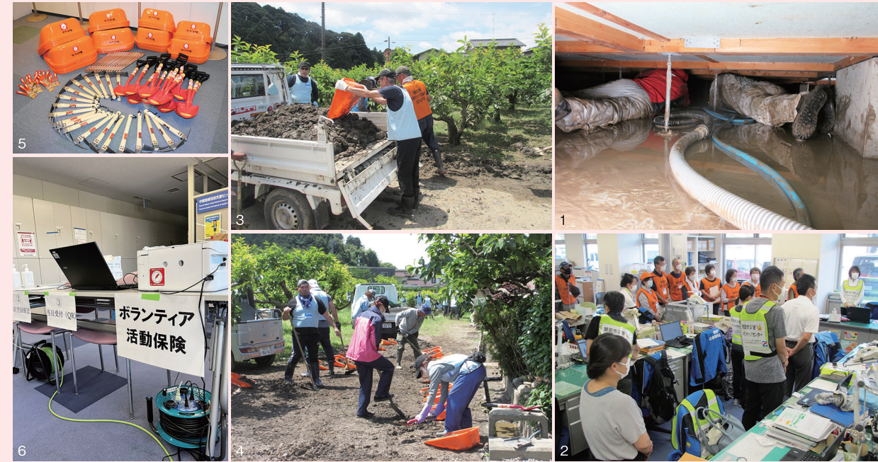
1.床下の泥については支援団体の指導の下、畳や床板を剥がし、床下に潜り込んでの泥かき作業に。2.本部とサテライトを設置。現場と本部が連携して支援した。3.役立ったのは荷台に直接泥を載せて運べる軽ダンプ。4.住宅や敷地内に集積した泥を取り除く作業。重機が入れない場所はボランティアが人力でかき出しを実行。5.赤い羽根共同募金の助成金で購入した道具類。6.事務機器も助成によるもの。
